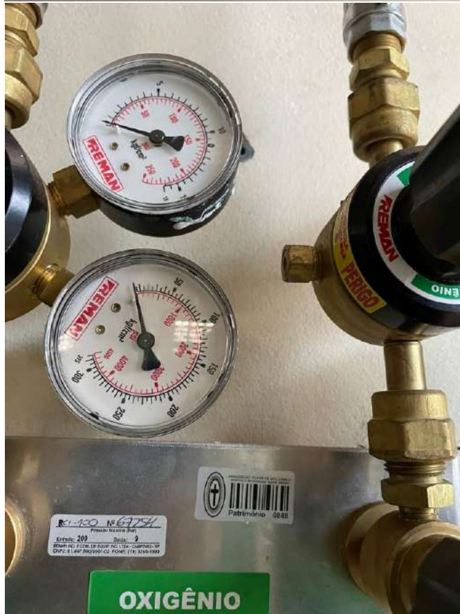
CENTRAL MANIFOLD O2 C/ VALVULAS – PATRIMÔNIO (Nº888)
